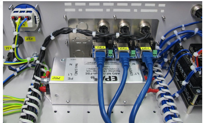
Bild 2: Netzfilter vor Ausgangsblende
