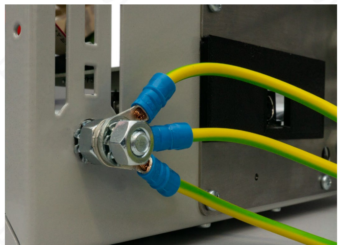
Bild 24: Erdungsverschraubung mit aufgelegten Kabeln
