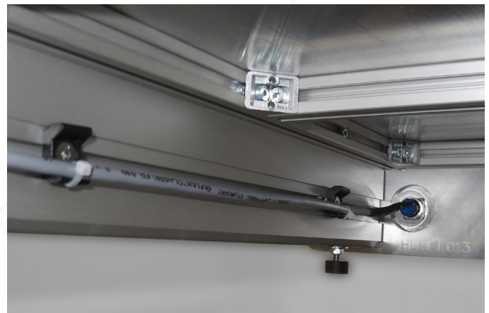
Bild 5: Steuerleitung zum Not-Aus-Schalter
